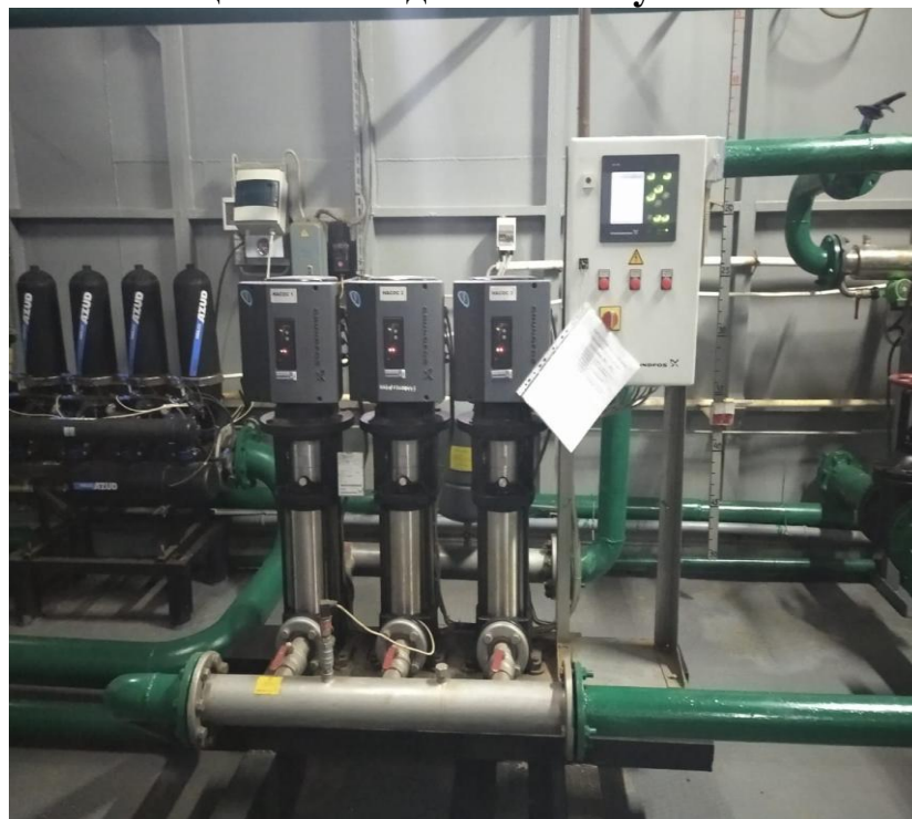
Рис. 6.8. Насосная станция 3-го подъема НС Hydro MPC-E3 CRE15-07
