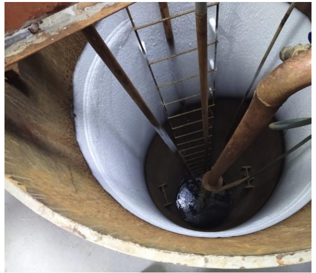
Рис. 6.3. Внутреннее техническое состояние стенок колодца
