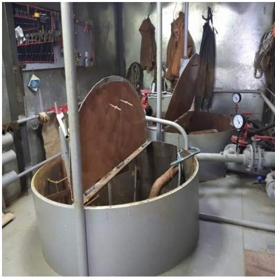
Рис. 6.2. Колодцы станции 1-го подъема
