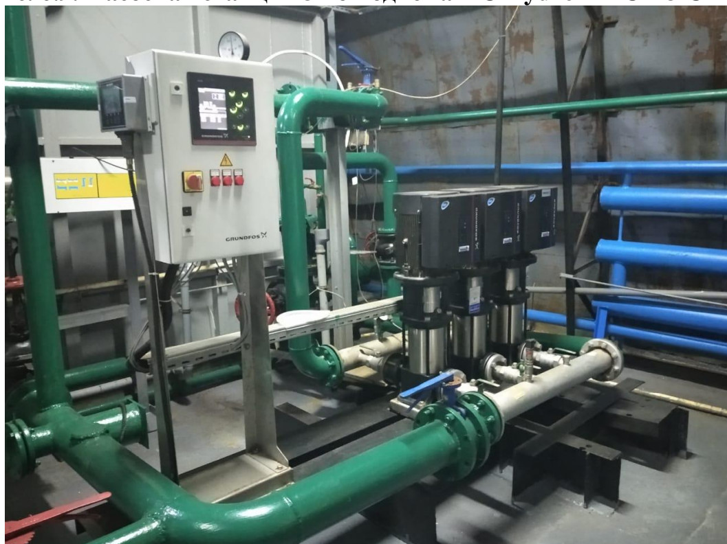
Рис. 6.9. Насосная станция 3-го подъема НС Hydro MPC-E3 CRE15-07
