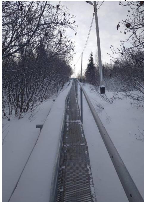
Рис. 6.4. Трубопроводы подачи исходной воды со станции 1-го подъема
