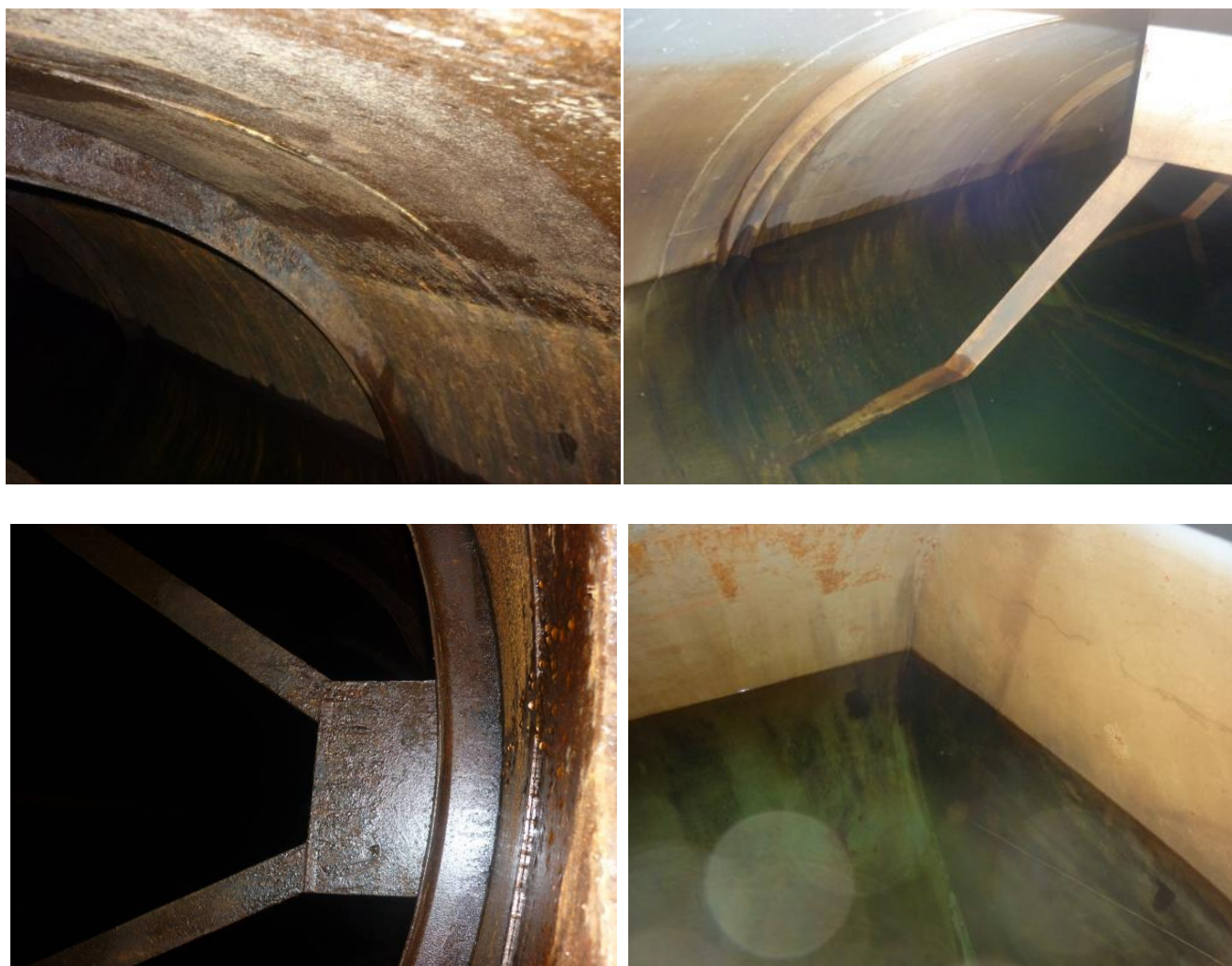
Рис. 6.24. Техническое состояние резервуаров
