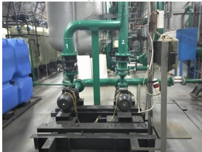
Рис. 6.11. Насосы 2-го подъема Grundfos NB 40-160/172
