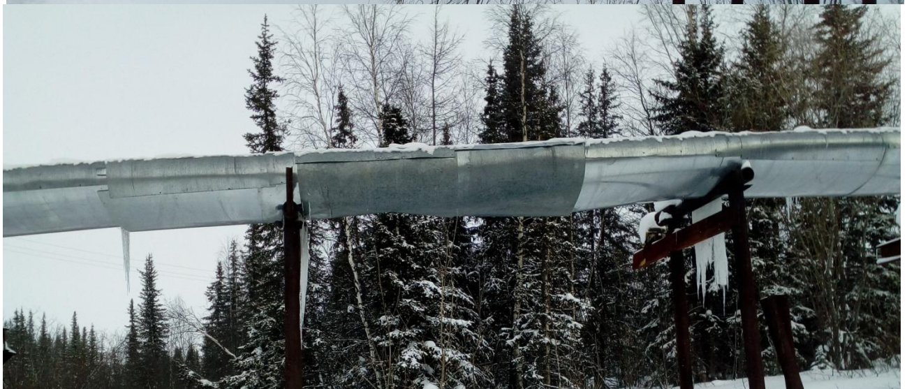
Рисунок 95. Результат затопления сетей из-за утечки водопровода на участке ТК5 – ТК5Б.
