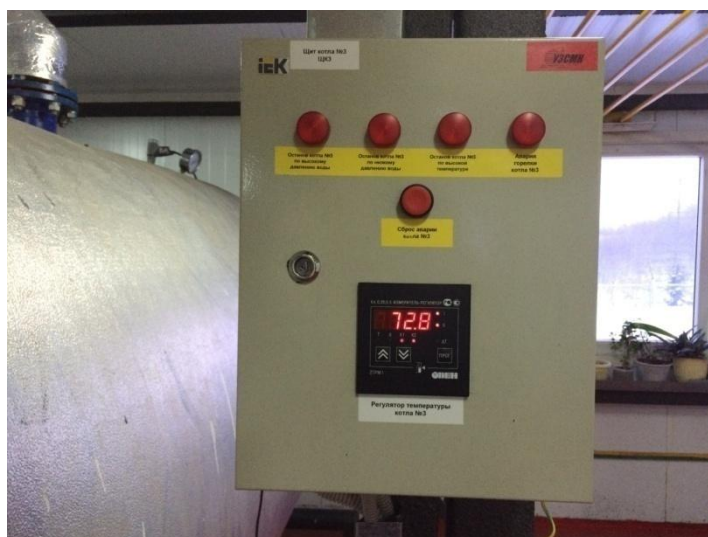
Рисунок 63. Пульт управления котлом №3.
