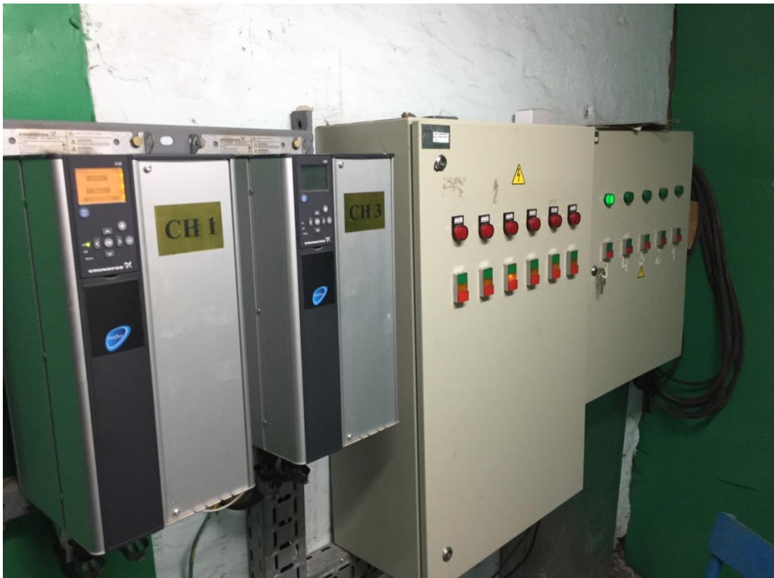
Рисунок 56. Щит управления насосами, частотный преобразователь сетевых насосов.
