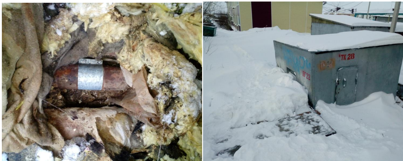
Рисунок 97. Результат затопления сетей из-за утечки водопровода на участке ТК28 – ЦЗН.
