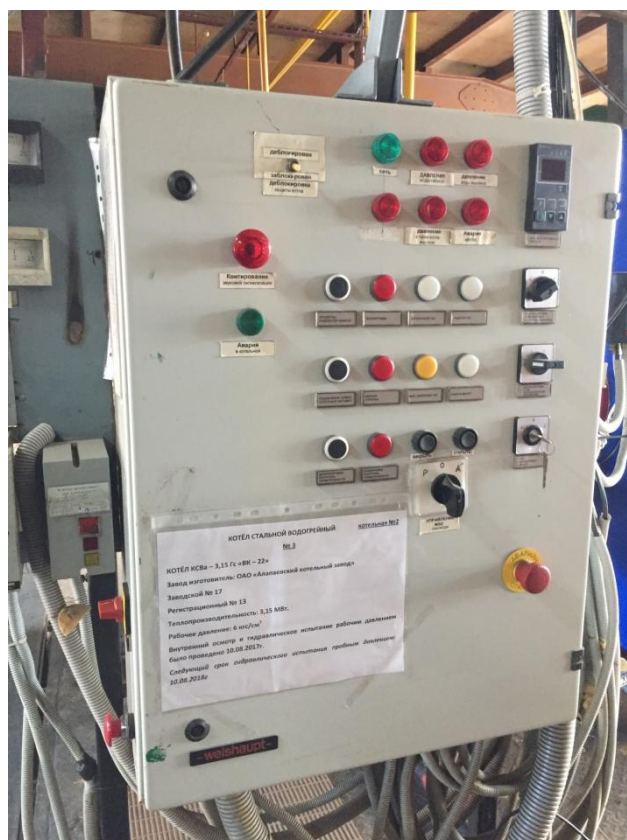
Рисунок 38. Пульт управления котлом №3.
