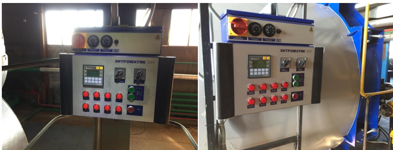
Рисунок 37. Пульты управления котлами №1 и №2.
