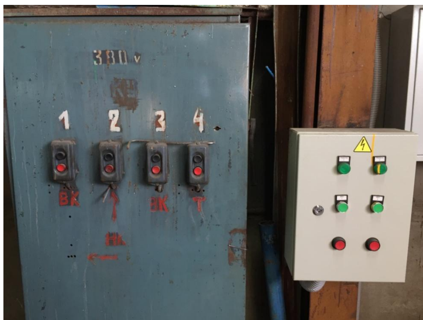
Рисунок 44. Щит управления сетевыми насосами №1 и №2.
