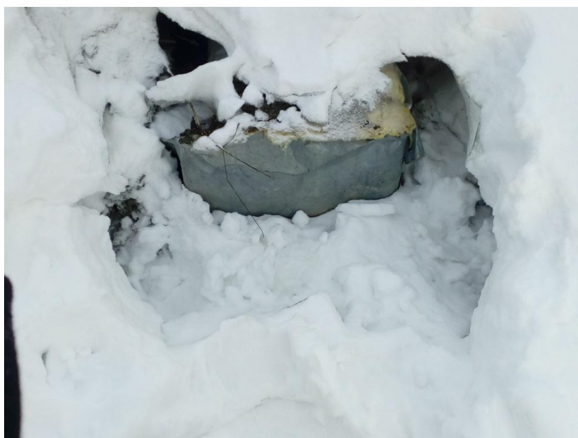
Рисунок 99. Провал грунта из-за утечки водопровода на участке по ул. Северная.
