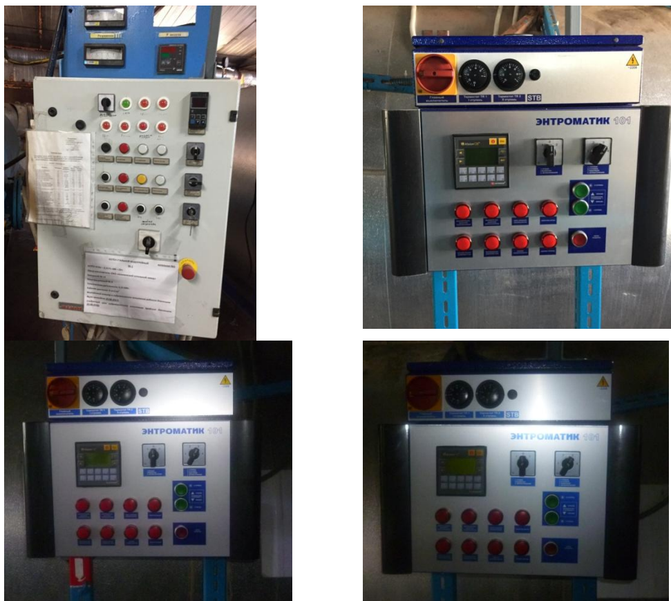
Рисунок 52. Пульты управления котлами.
