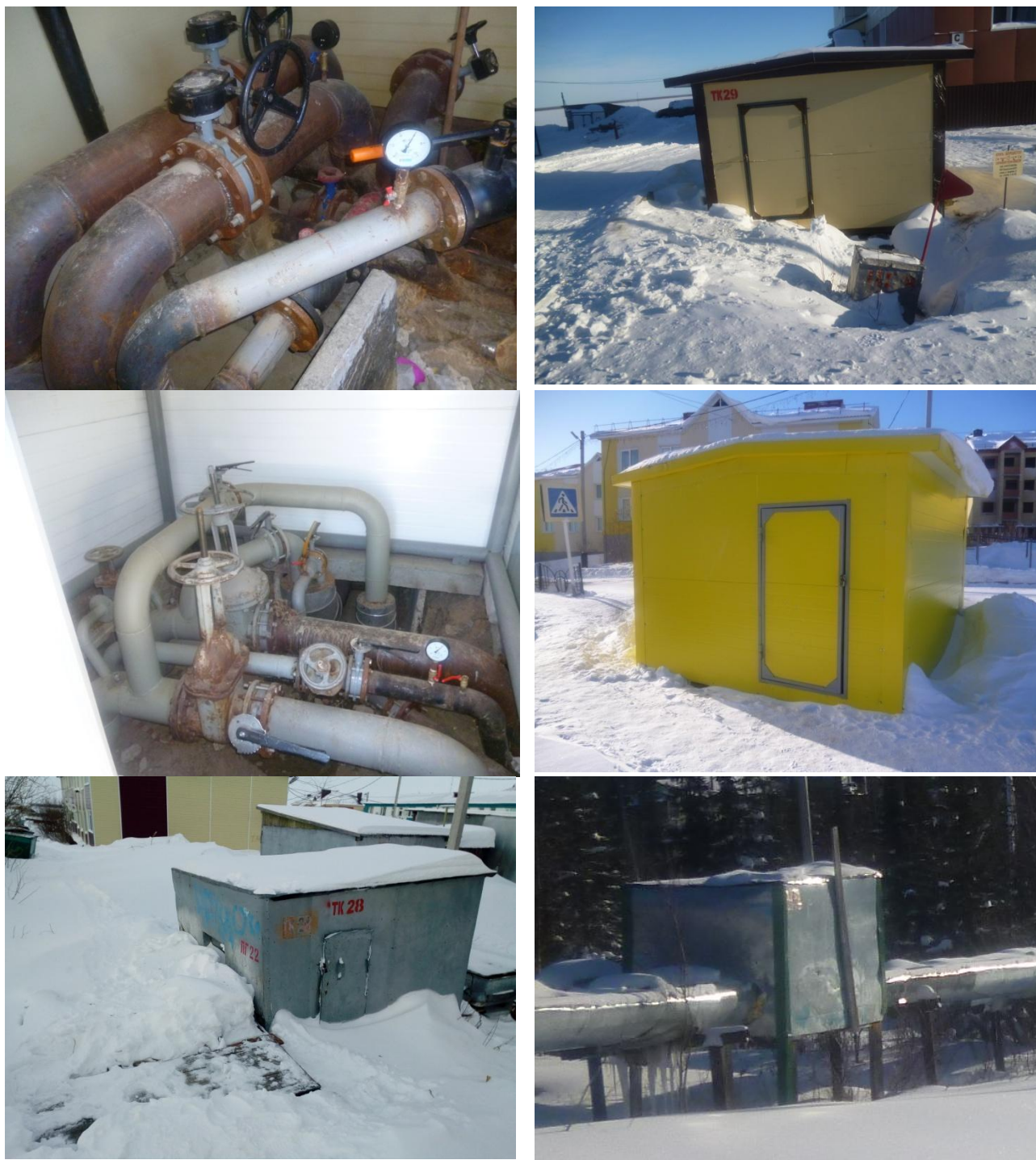
Рисунок 89. Примеры тепловых камер. с Аксарка
