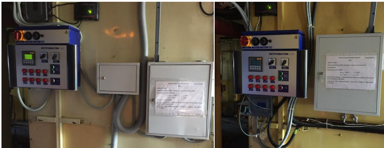
Рисунок 26. Пульты управления котлами.
