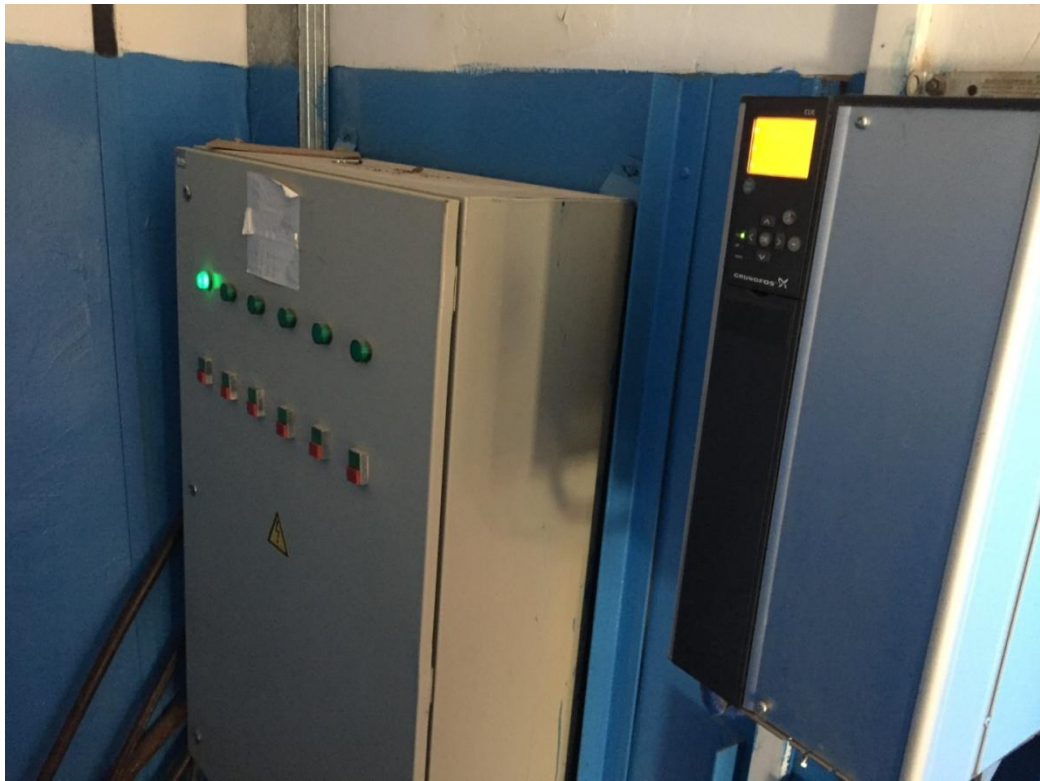
Рисунок 30. Щит управления насосами, частотный преобразователь сетевых насосов.
